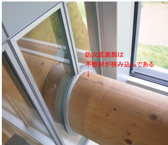
□ガラスの防火区画を貫通する木部
